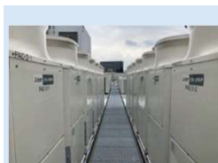
空調設備の更新 (Daiwa銀座ビル)
