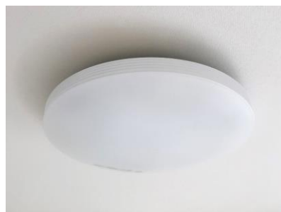
専有部のLED照明導入 (TKフラッツ渋谷)
